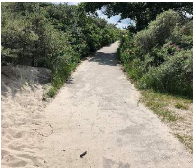
Eksisterende rampe ved Ishøj – i dag ujævn asfalt.
